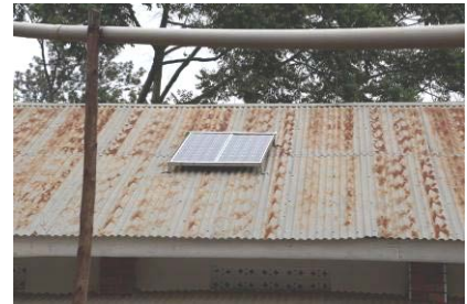
Een van de daken met zonnepanelen
